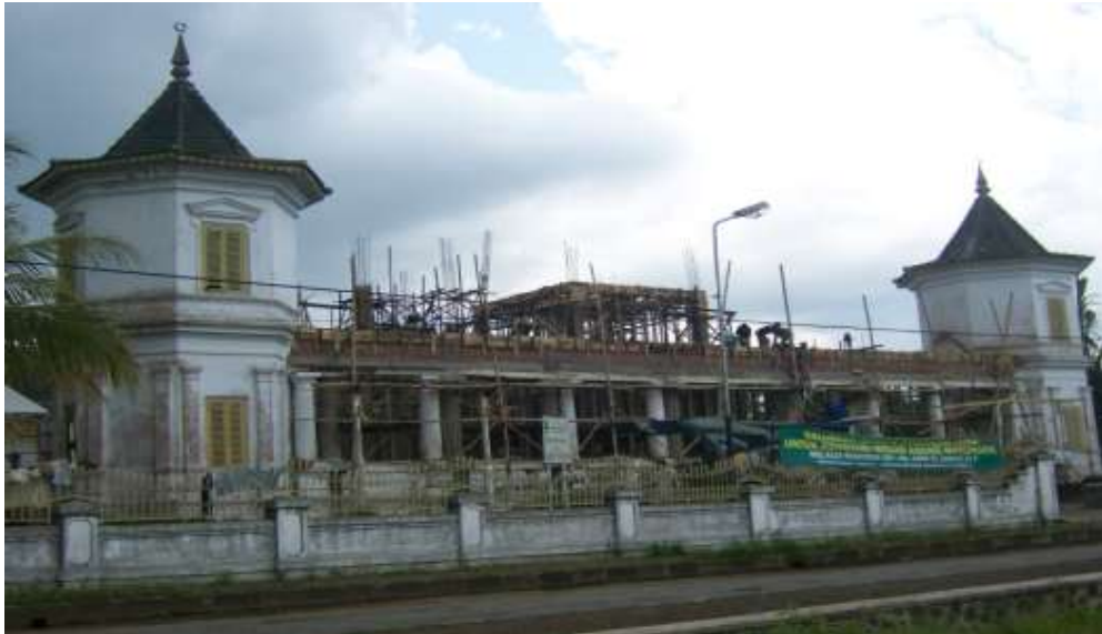
Rehabilitasi Masjid Manonjaya yang rusak berat akibat gempa (Sumber: Dokumentasi Tim Visualisasi)
